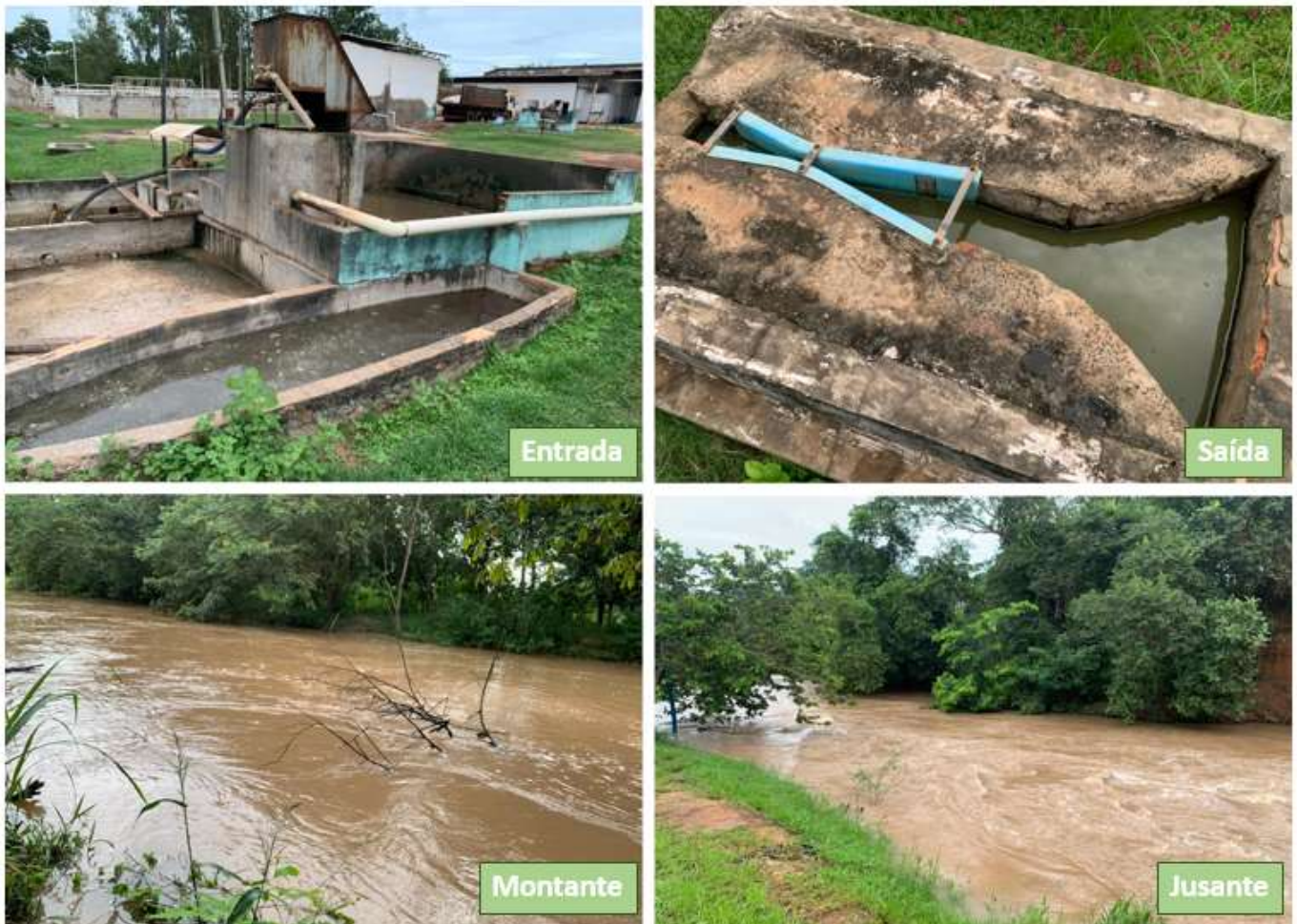
Figura 6– Ponto1: Entrada do Sistema de Tratamento (efluente bruto); Ponto 2 – Saída do Sistema de Tratamento (efluente tratado); Ponto 3 – Montante do lançamento (corpo hídrico); Ponto 4 – Jusante do lançamento (corpo hídrico).
