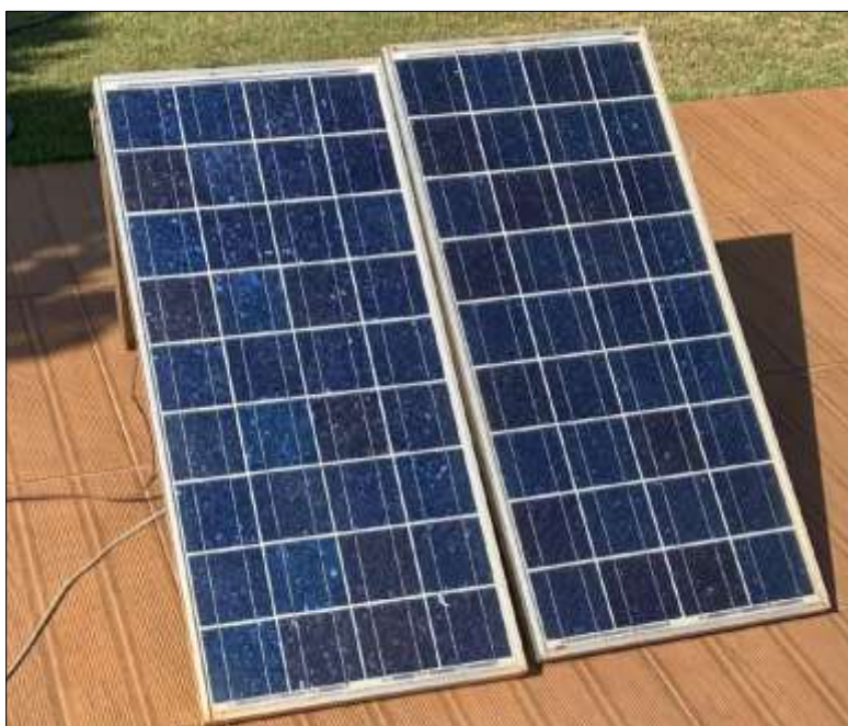
Figura 14 – Módulos fotovoltaicos em condições normais.
