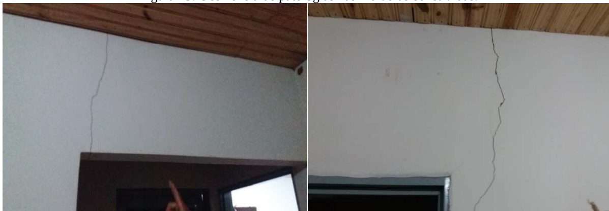
Figura 43: Ocorrência de patologias nas moradias construídas.
