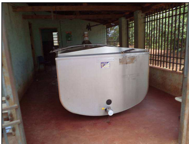
Figura 10 – Tanque de resfriamento da COAPAR instalado na sede no assentamento Cafeeira em Castilho-SP. Fonte: trabalho de campo, mar. 2012.
