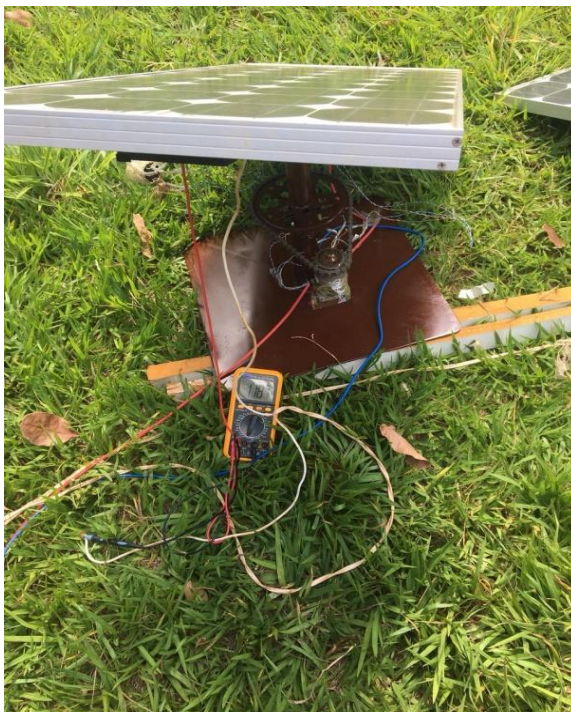
a) Rastreador solar em campo
