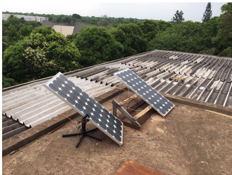
Figura 21 Estrutura fixa e o Rastreador solar azimuthal
