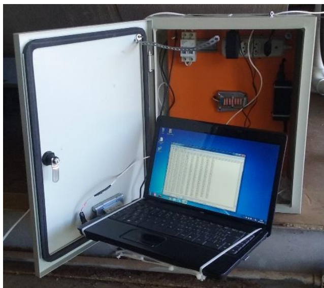
Figura 37 – Computador preso a tampa da caixa metálica
