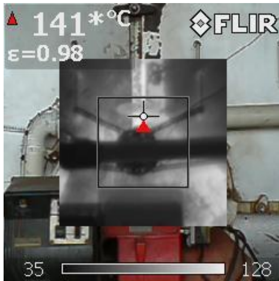
Figura 67 – Termografia da caldeira
