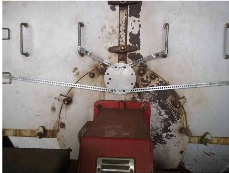
Figura 35 - Coletor de calor na caldeira
