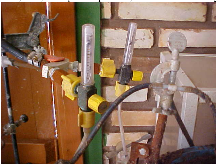
Figura 4.5. Detalhe do rotâmetro de ar comprimido.
