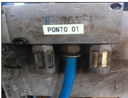
Figura 49 - Ponto de vazamento 01.
