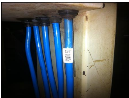
Figura 50 - Ponto de vazamento 50.
