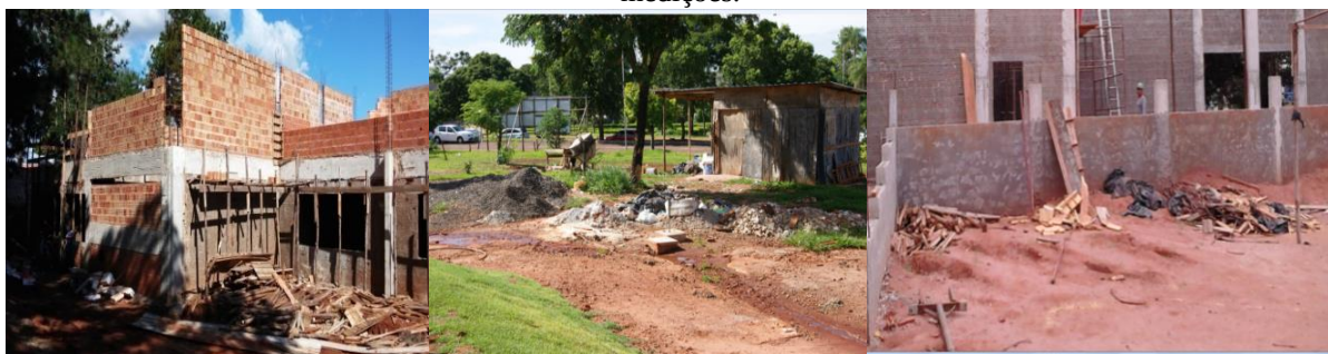
Figura 6 - Fotos da situação dos resíduos em obras no Campus de Campo Grande – registros em relatórios de medições.
