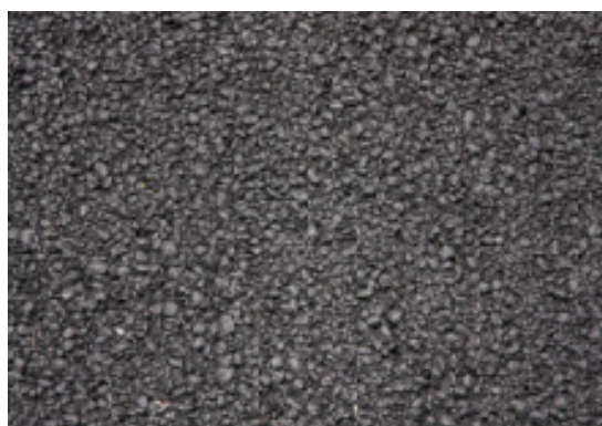
Figura 4.23: Asfalto poroso Fonte: Martins, 2006
