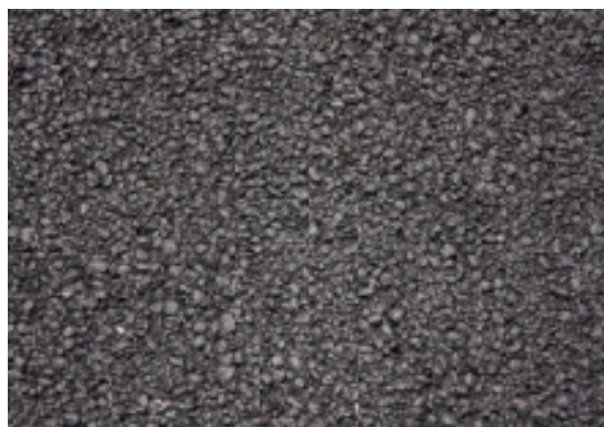
Figura 4.23: Asfalto poroso Fonte: Martins, 2006
