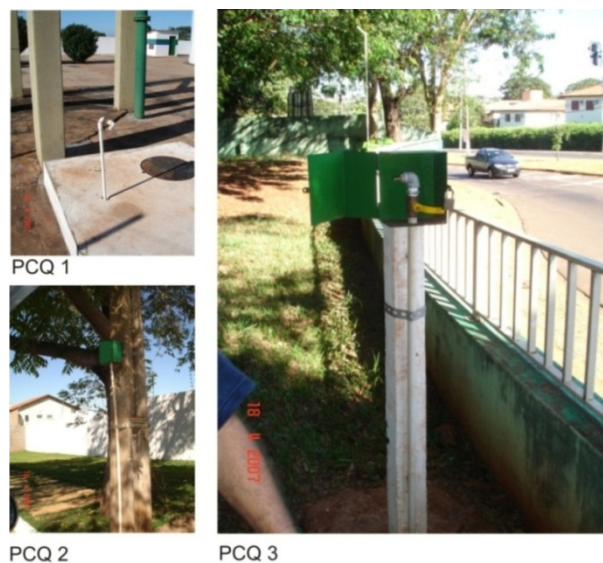
Figura 4.5 - Detalhe dos PCQs.
