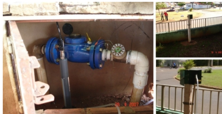
Figura 5.11 - Ponto de instalação - Sonda 2.
