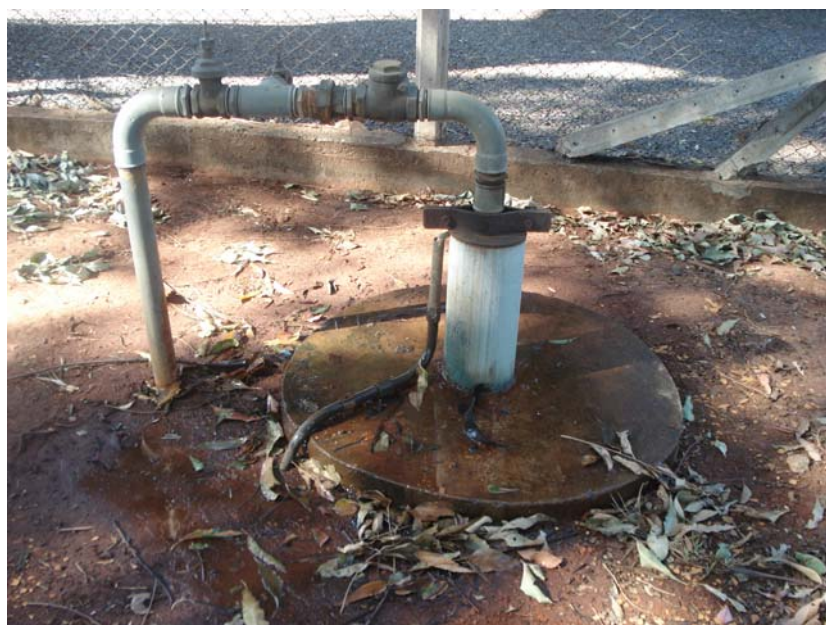
FIGURA 8.3 – Poço Tubular na área do Câmpus da UFMS.
