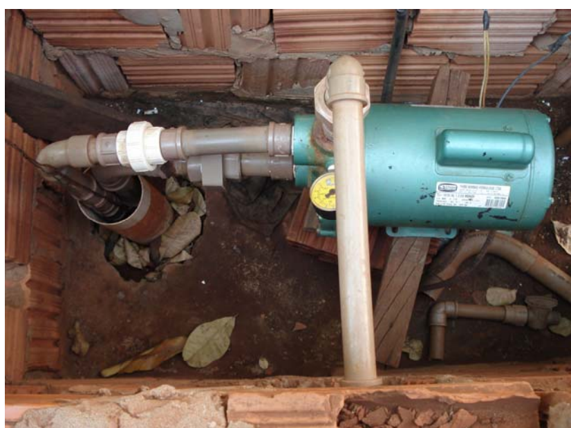
FIGURA 8.4 - Poço Raso. Observar a inexistência de laje de proteção e de tampa para a boca do poço.
