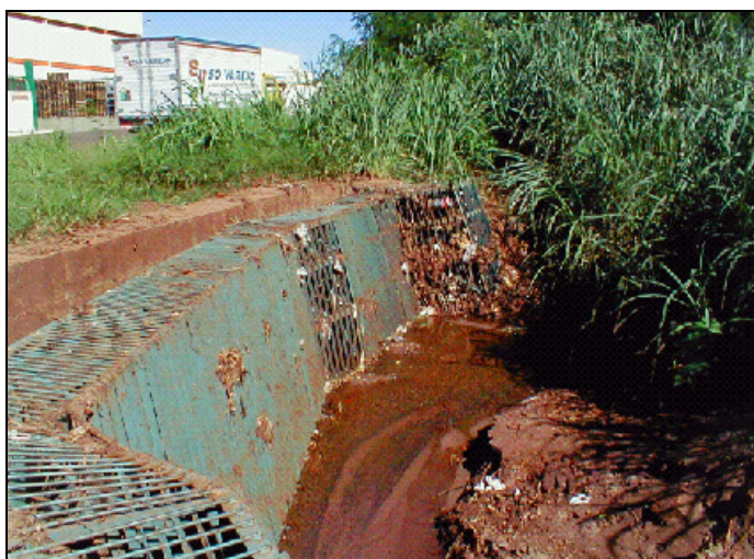
Figura 51: Exemplo de uma grelha de proteção de bueiros, que retém materiais sólidos, contribuindo para inundações (junho, 2002).
