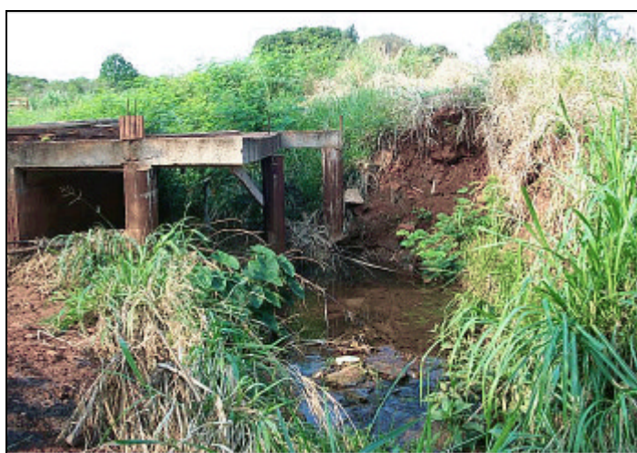
Figura 52: Exemplo de construção irregular, o pilar está apoiado no leito do córrego, retendo entulhos (junho, 2002).
