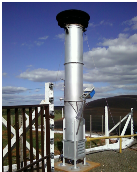
Figura 51 - Flare para queima de biogás
