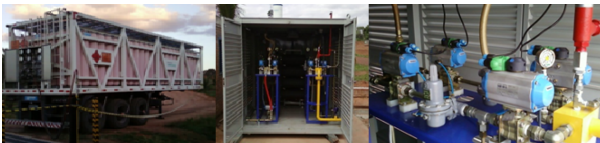
Figura 73 - Uma carreta de GNC e container para rebaixamento de pressão.
