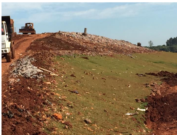
Figura 42 - Cobertura vegetal parcial do talude.
