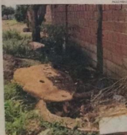
Grave. Fossa entulhada e próxima a poço d'água ameaça a saúde
