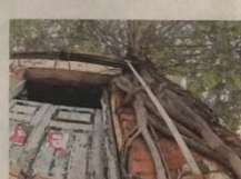
Árvore invade pela 2ª vez a casa 469 da Rua 14 de Julho
