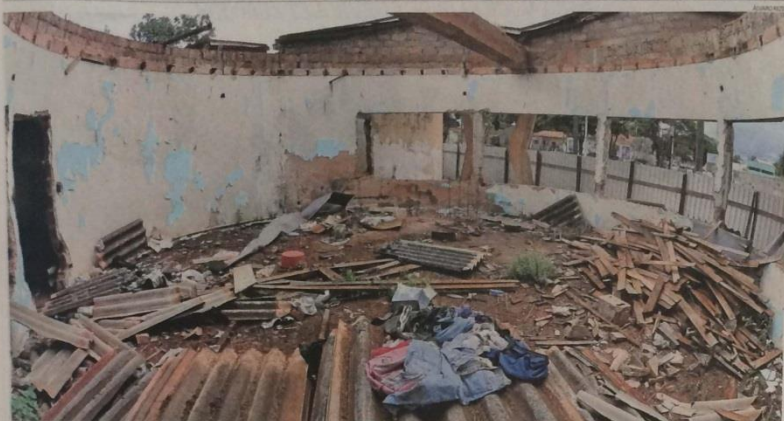
Depósito de entulhos. Ex-albergue foi parcialmente demolido pela prefeitura, não teve a destinação prometida e virou moradia para sem-teto, incomodando comerciantes e moradores da região
