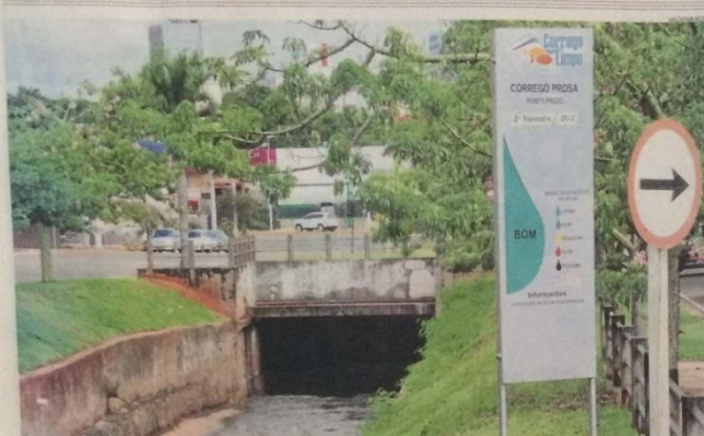
Ideal seria sempre o verde. Placa colocada pela Secretaria Municipal de Meio Ambiente na Avenida Fernando Corrêa indica a qualidade da água do Prosa
