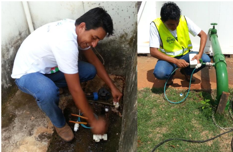
Figura 11 - Medição de pressão
