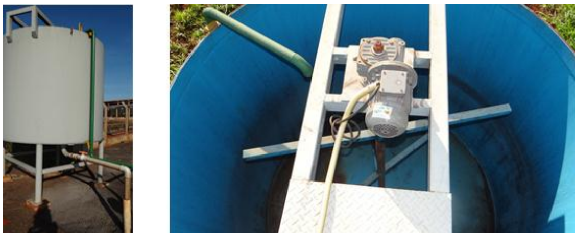
Figura 7.11 - Detalhes Tanque de Equalização
