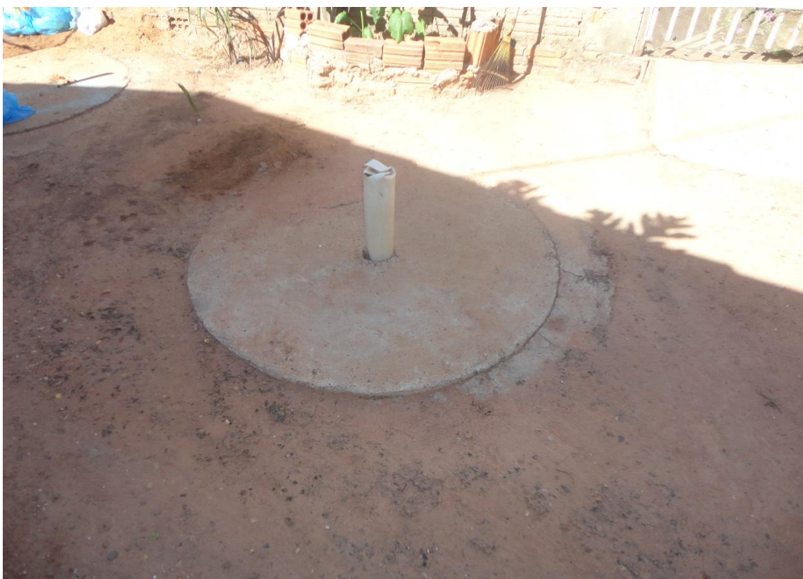
Figura 13: Fossa séptica no conjunto habitacional Imperial. Foto: ALVES SILVA, C.A., 2014.
