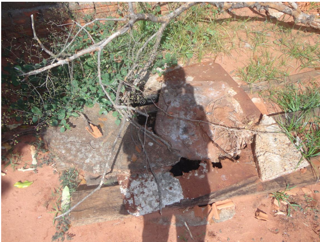
Figura 14: Fossa séptica no conjunto habitacional Orquídeas II.
