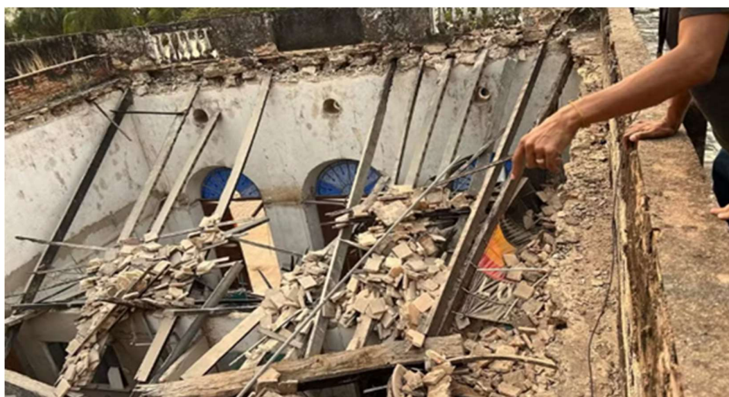
Figura 11 - Estado da estrutura do prédio histórico na Rua Manoel Cavassa após o desabamento
