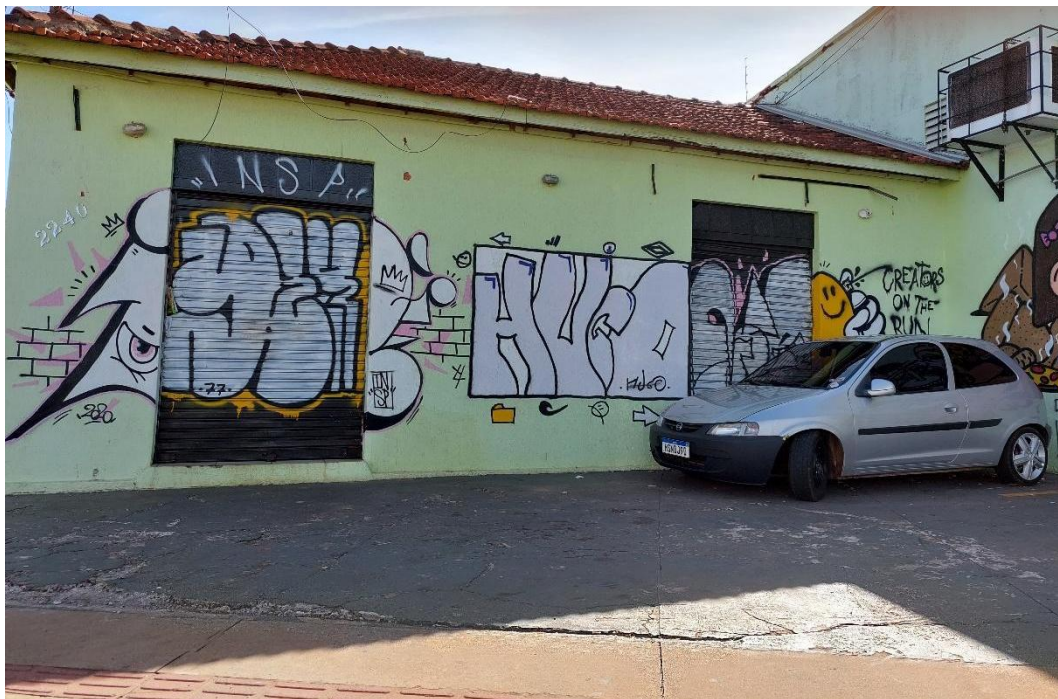
Rua Bela Vista, Vila Palmira – MURO RESIDENCIAL – 14/07/2022, 09h38
