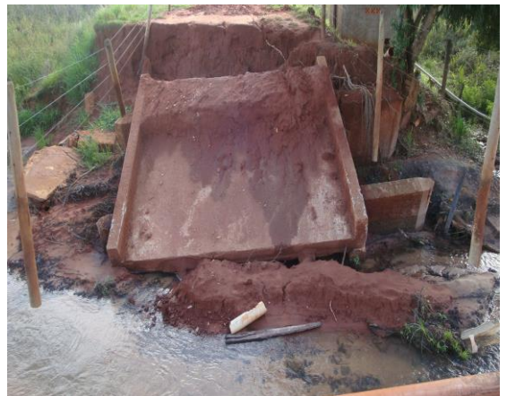
Ponto 10- Ponte caída na área do córrego
