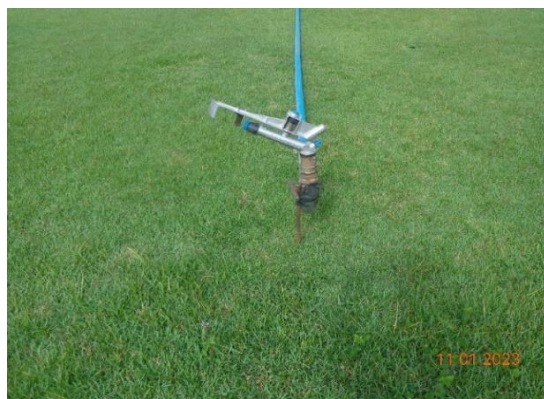
Figura 18. Aspersor de 2" para irrigação do gramado
