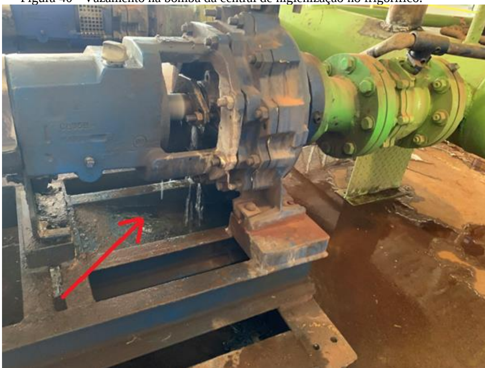
Figura 40 - Vazamento na bomba da central de higienização no frigorífico.
