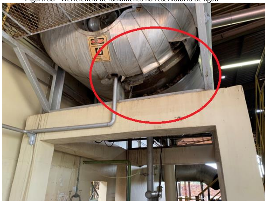
Figura 35 - Deficiência de isolamento no reservatório de água
