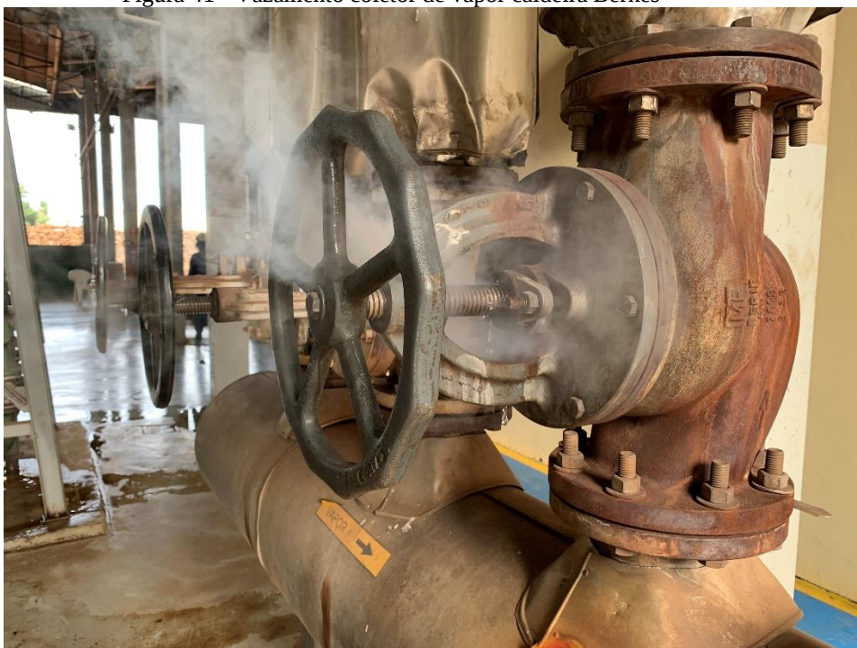
Figura 41 - Vazamento coletor de vapor caldeira Berkes
