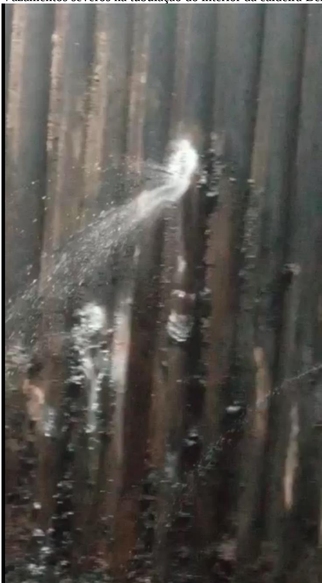
Figura 39 - Vazamentos severos na tubulação do interior da caldeira Berkes
