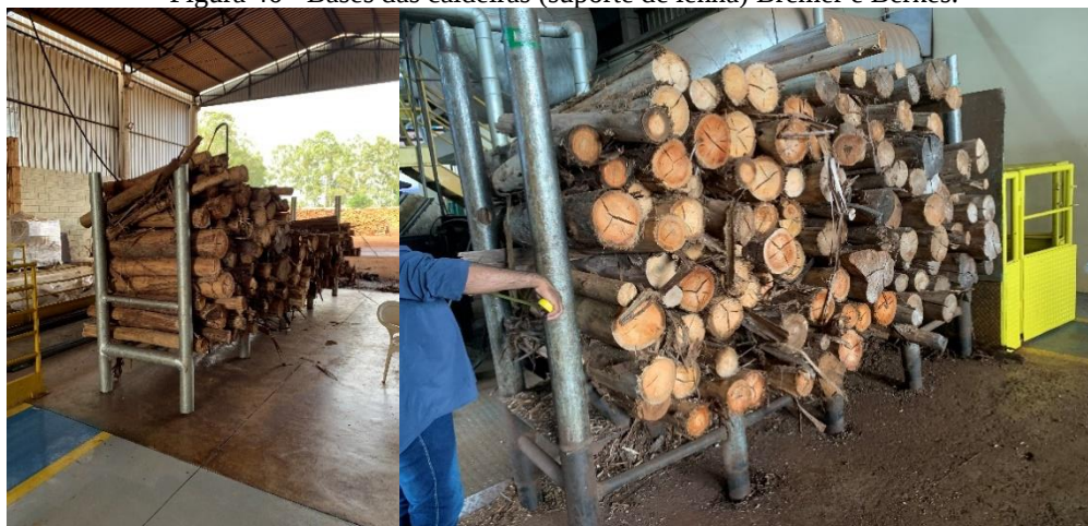
Figura 46 - Bases das caldeiras (suporte de lenha) Bremer e Berkes.
