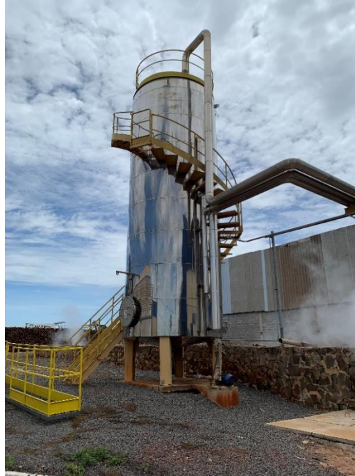
Figura 58 - Reservatório de condensado
