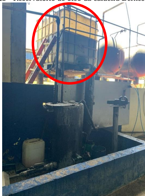
Figura 25 - Reservatório de óleo da caldeira Berkes.
