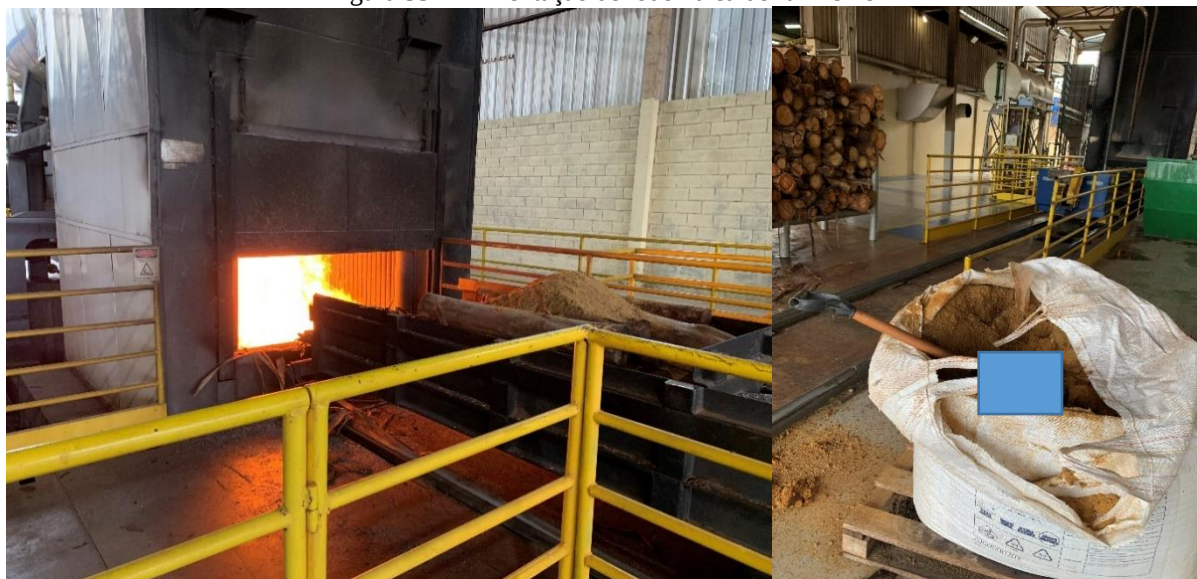
Figura 55 - Alimentação de lodo na caldeira Bremer
