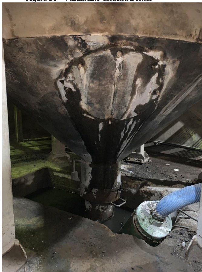
Figura 36 - Vazamento caldeira Berkes
