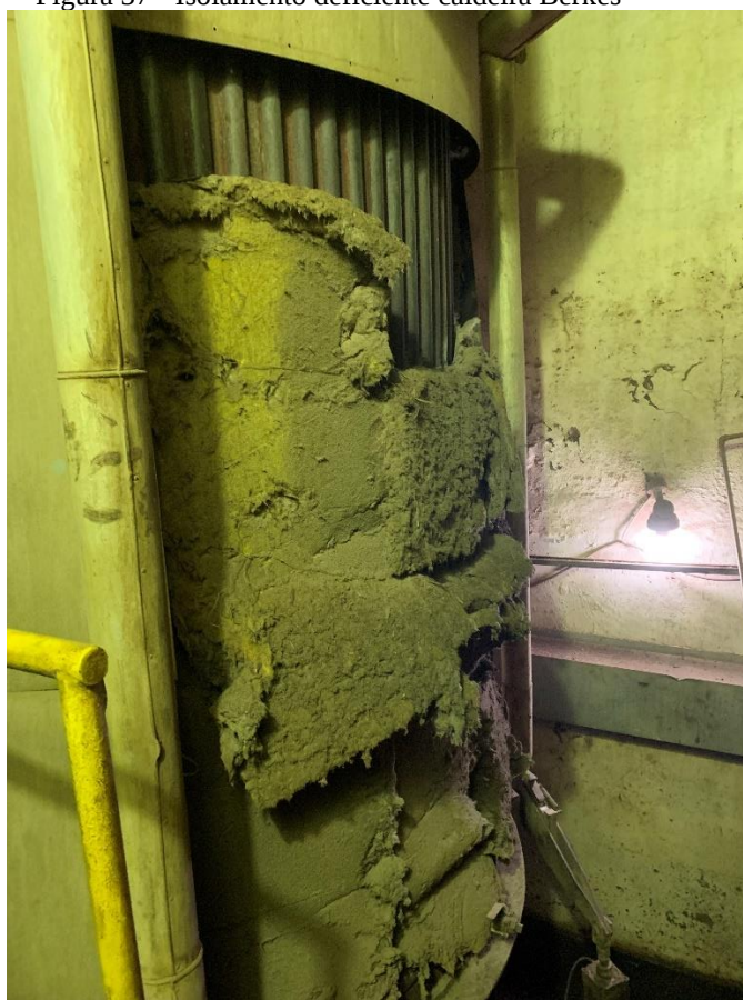
Figura 37 - Isolamento deficiente caldeira Berkes
