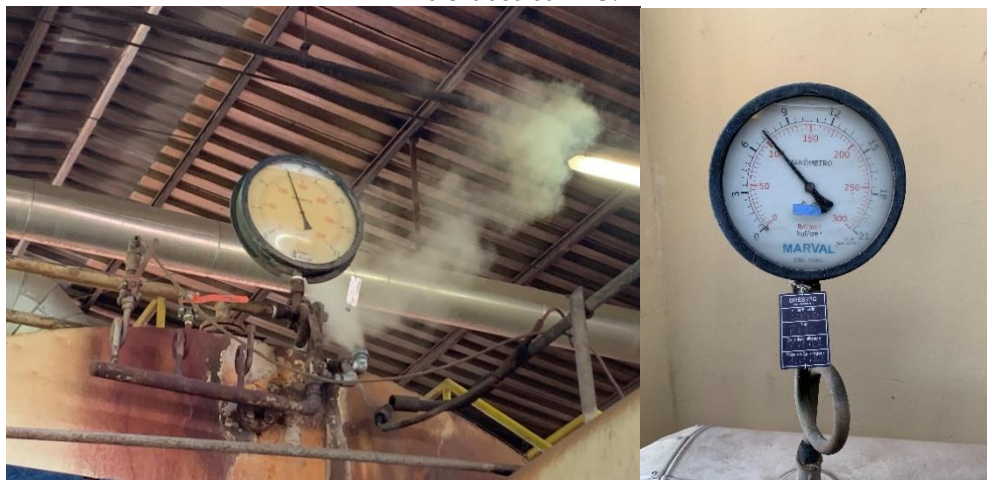
Figura 48 - Medidores caldeira Berkes, o da esquerda mede a pressão de saída da caldeira e o da direita a pressão na entrada da FFO.
