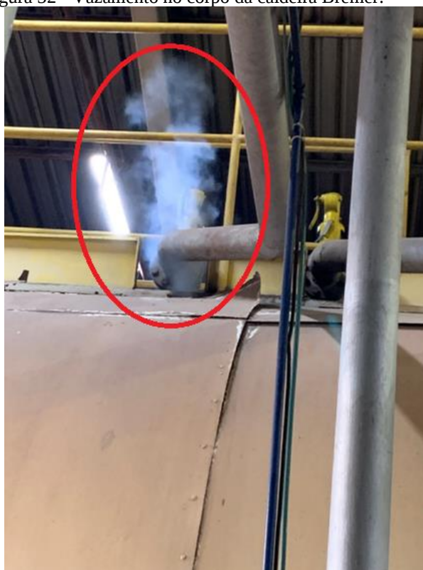
Figura 32 - Vazamento no corpo da caldeira Bremer.
