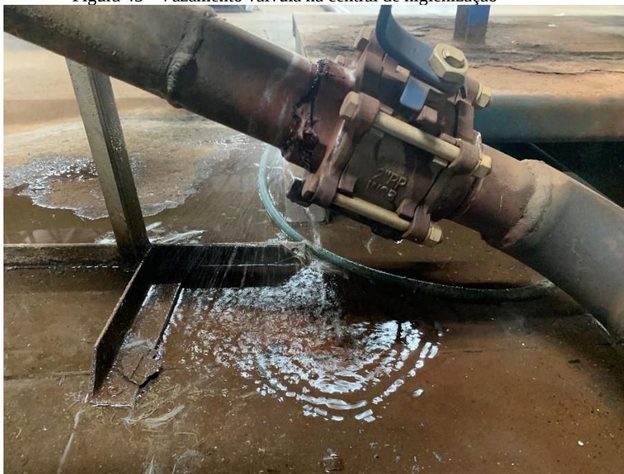
Figura 43 - Vazamento válvula na central de higienização
