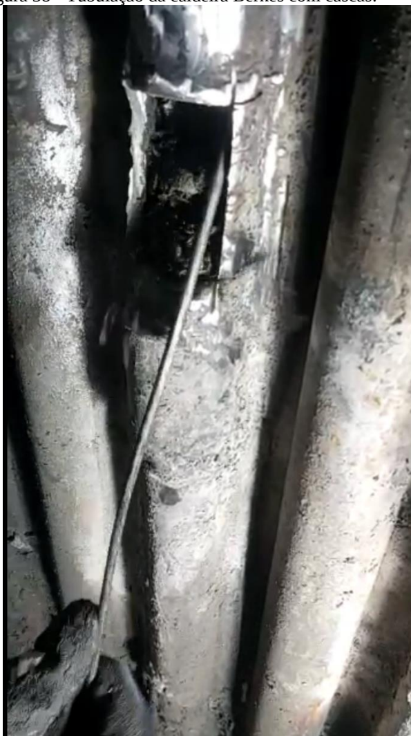
Figura 38 - Tubulação da caldeira Berkes com cascas.
