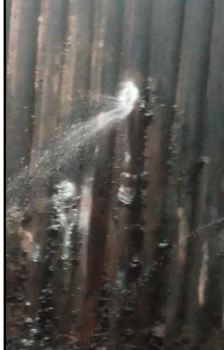
Figura 52 - Vazamento tubulação caldeira Berkes.
