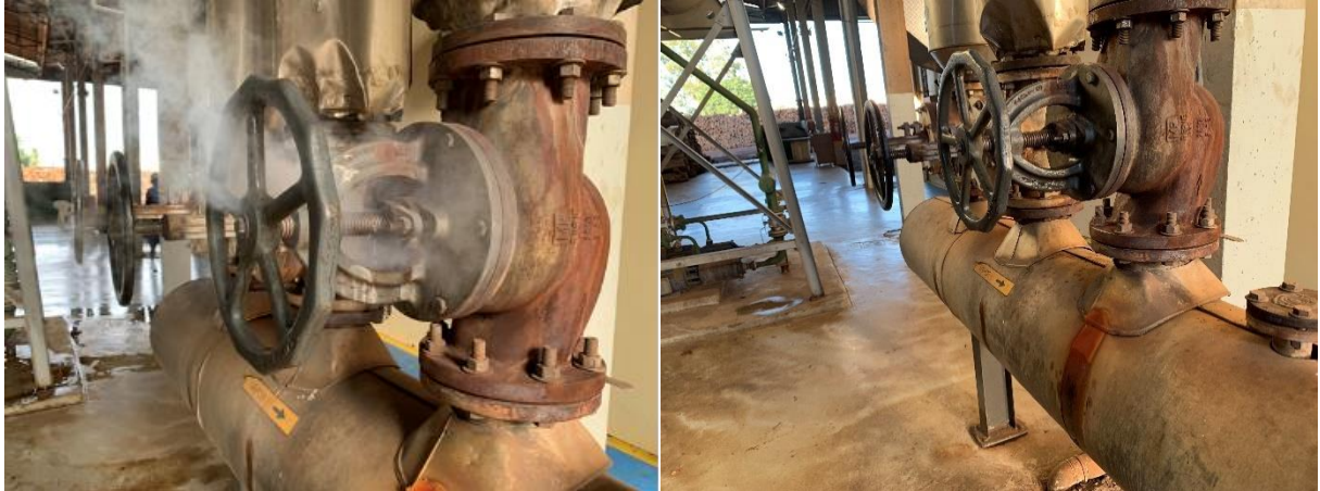
Figura 54 - Antes e depois coletor de vapor caldeira Bremer
