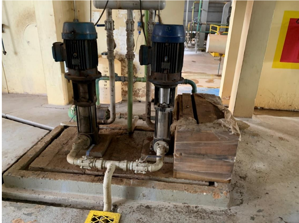
Figura 34 - Bombas da caldeira Bremer que estavam sem dados de ultima manutenção preventiva e com alta vibração.
