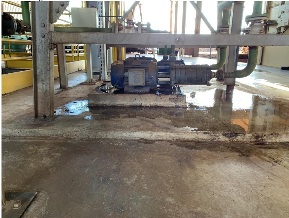
Figura 42 - Vazamento bomba de alimentação caldeira Berkes.
