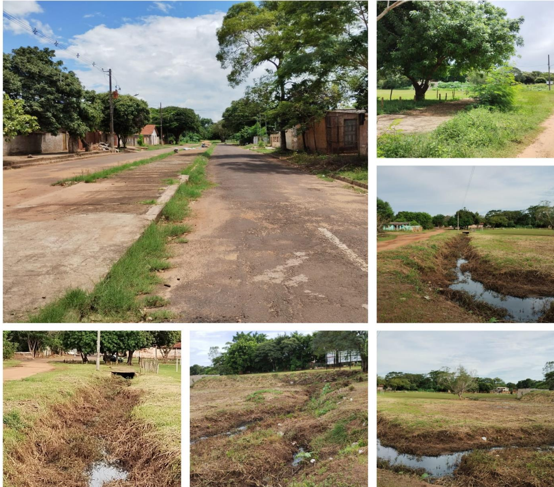
Figura 13 - Esgoto a céu aberto em área do território da Unidade de Saúde da Família Guanandi
