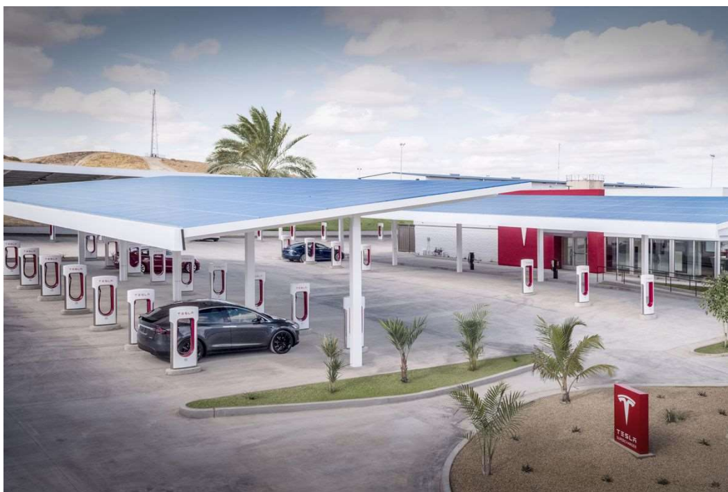
Figura 4 - Estação de recarga Supercharger da TESLA
