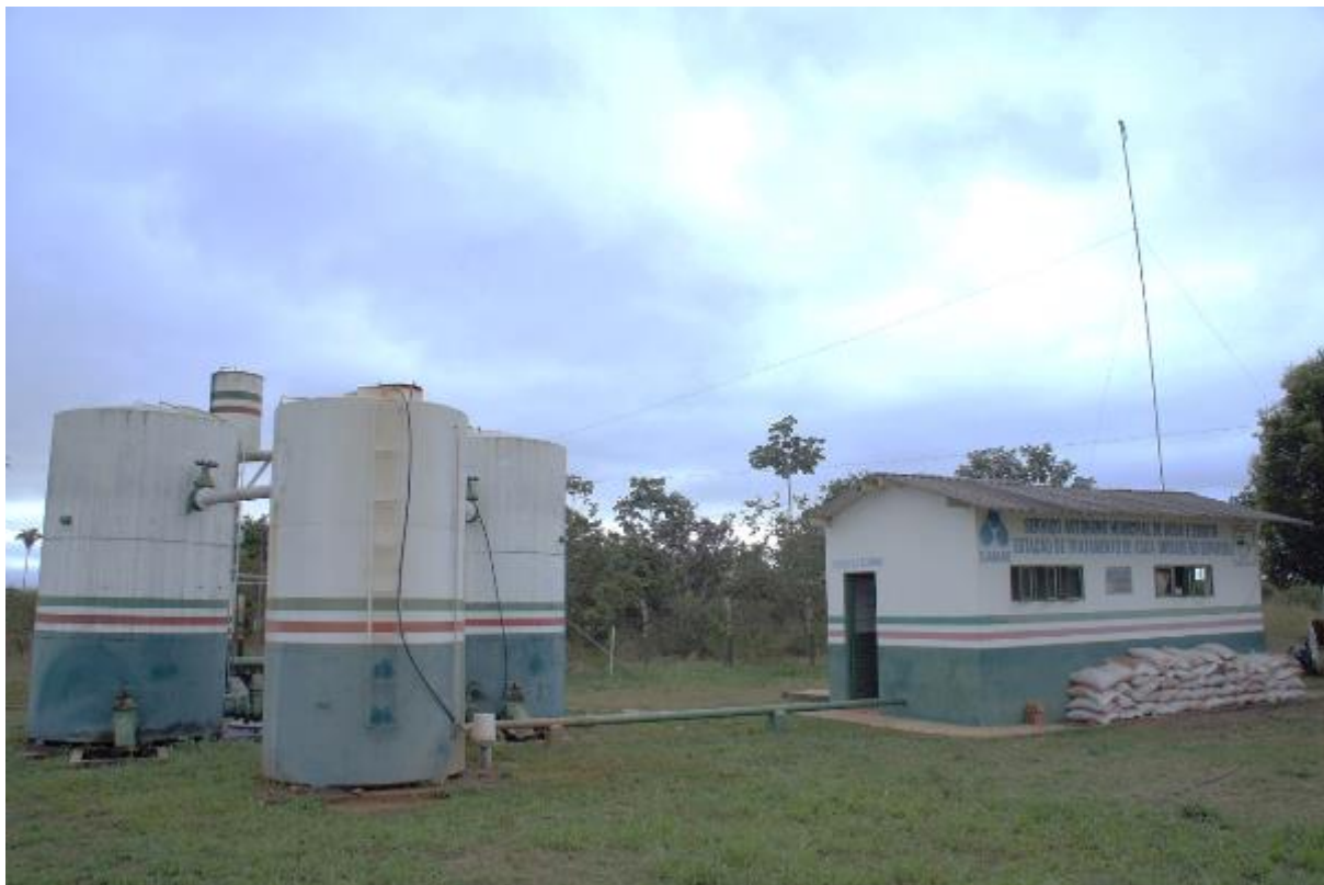
Figura 46: estação de captação e tratamento de água no Assentamento Antônio Conselheiro – município de Tangará da Serra/MT. Fonte: Tayrone Roger Antunes de Asevedo (2012).
