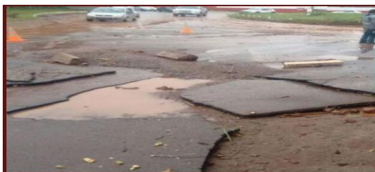
Figura 56 – Asfalto Danificado após a Chuva - Rotatória Rua Rachid Neder
